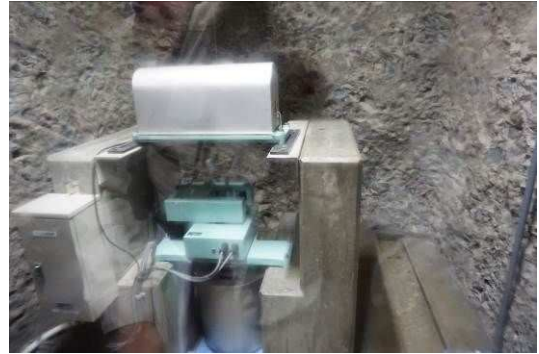
写真-1 桂沢ダム堤体たわみ測定器（プラムライン）
